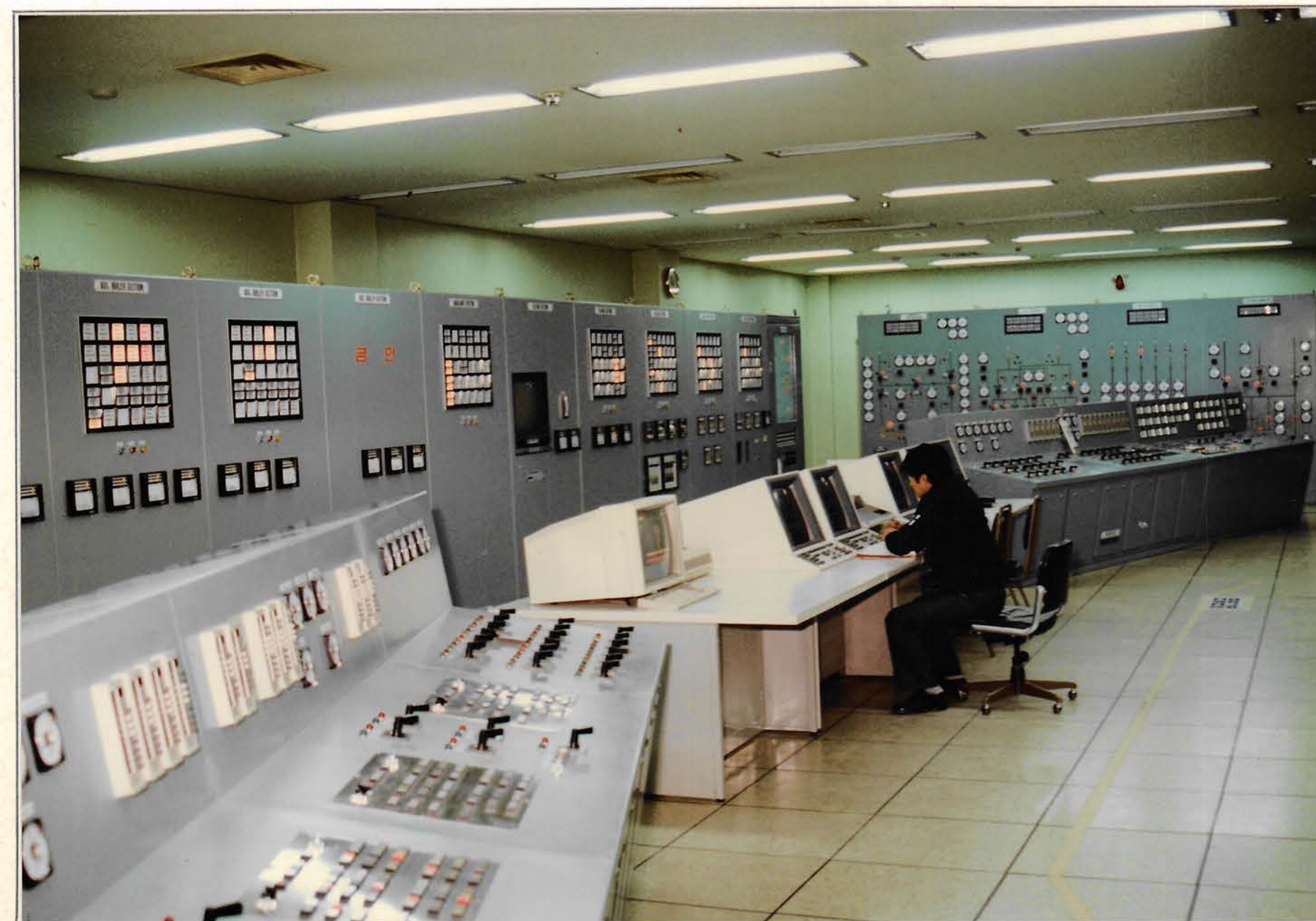
中央制御設備
