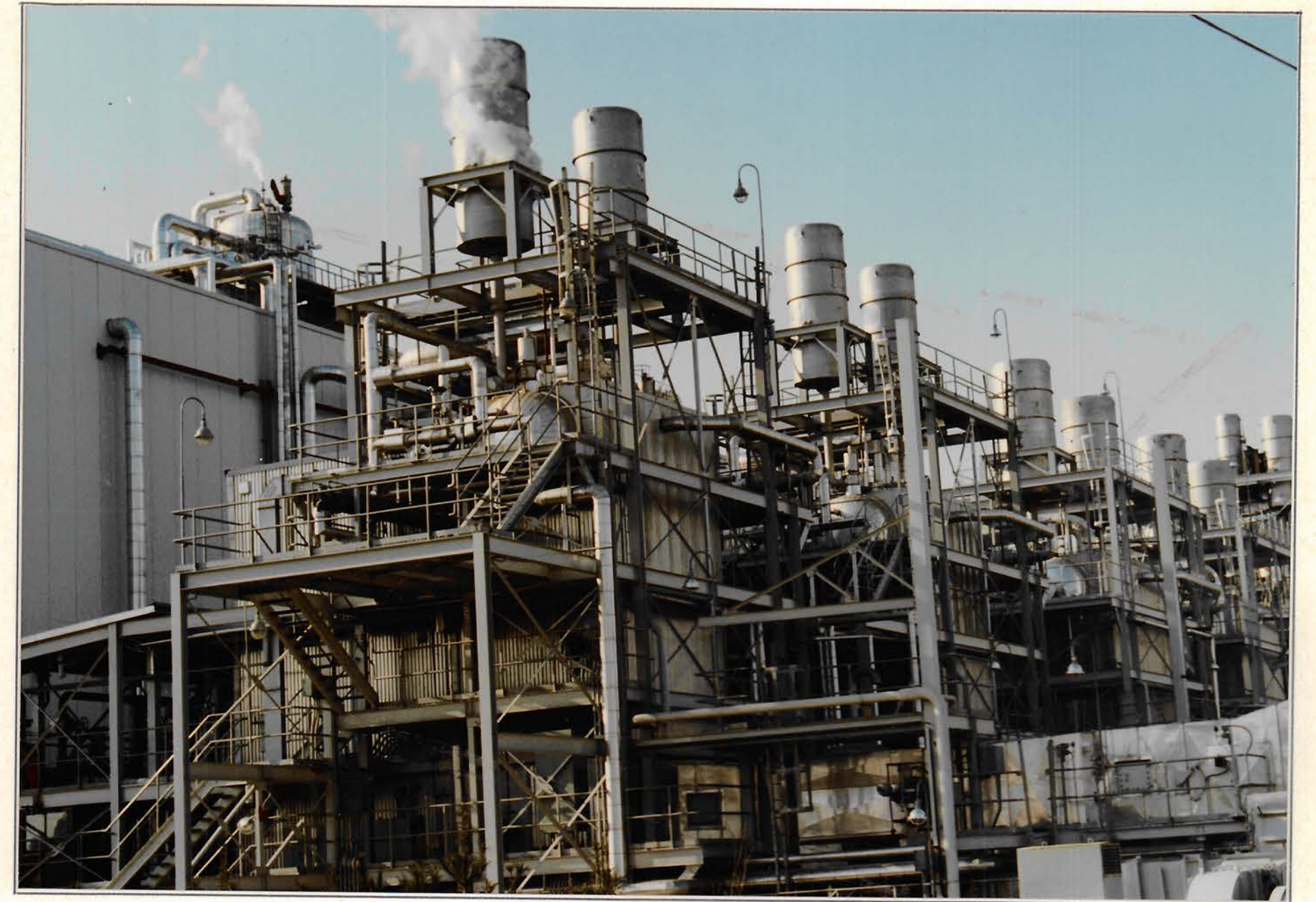
暖房用보일러施設
